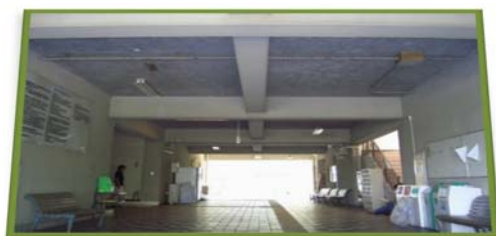
(体育館通路天井) アスベスト除去前
