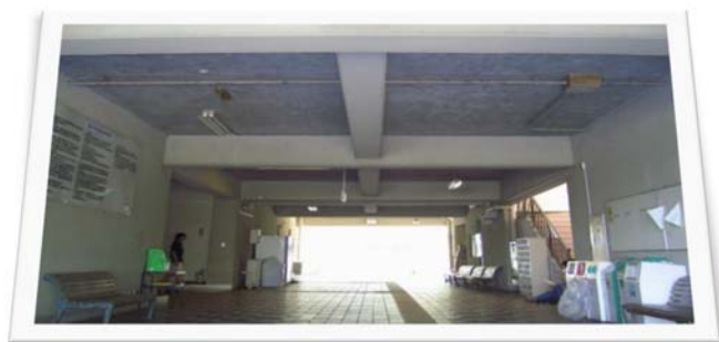
(体育館通路天井)アスベスト除去前
