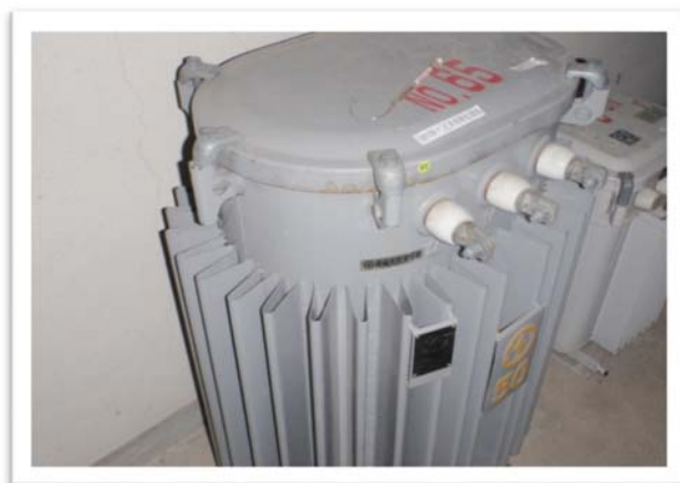
低濃度PCB保有トランス
