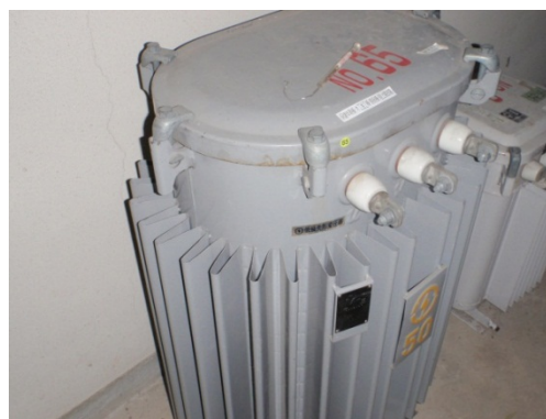
低濃度PCB保有トランス
