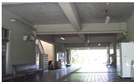
(体育館通路天井)アスベスト除去前
