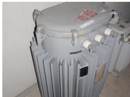
低濃度PCB保有トランス
