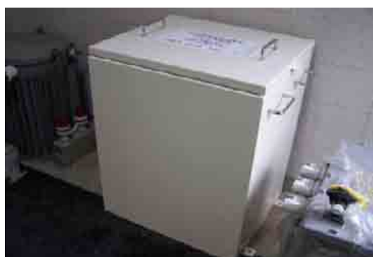
PCB保管箱(外部)
