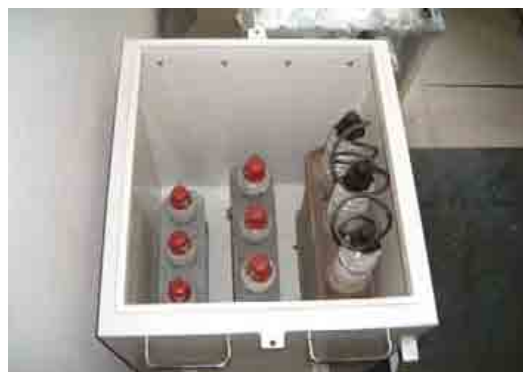
PCB保管箱(内部)
