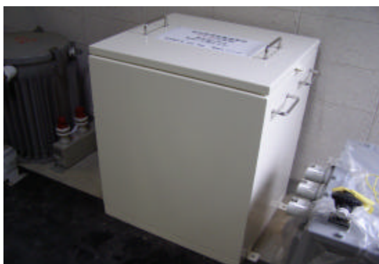
PCB保管箱 外部)
