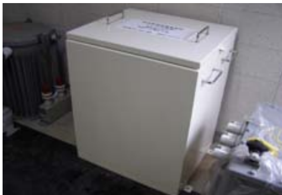
処理済みPCB保管箱(外部)
