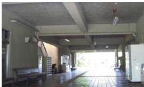
(体育館通路天井)アスベスト除去前
