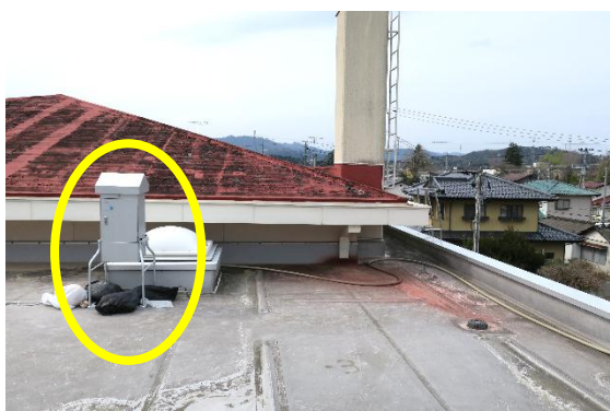
HVエアサンプラの設置状況 (大熊町公民館屋上)
