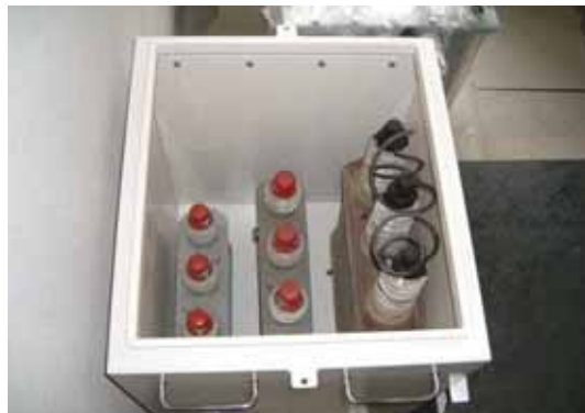
PCB保管箱(内部)
