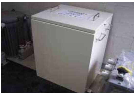
PCB保管箱(外部)
